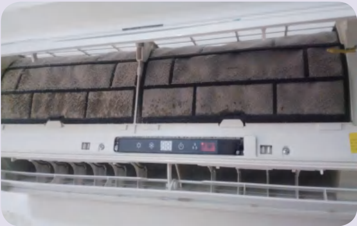
图4-14 空调进气栅过滤网上布满灰尘
