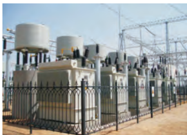
图 3-3-1 变电站大型变压器
