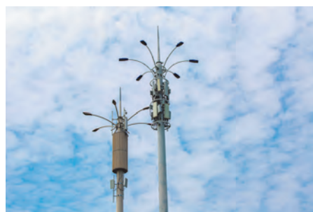
图 8-11 移动通信基站
