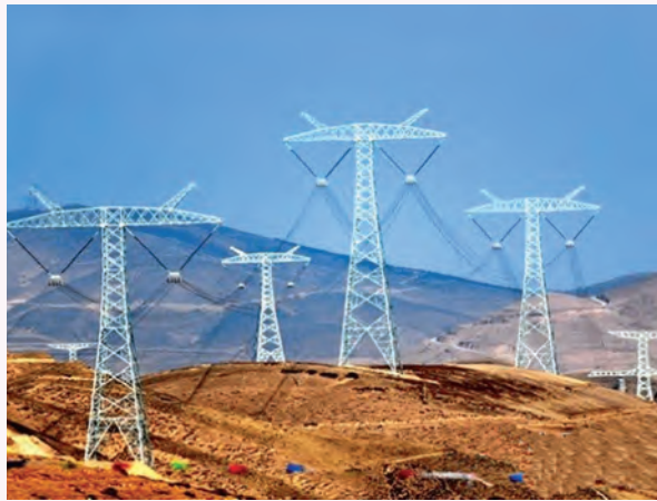
图 7-34 特高压直流输电线路
