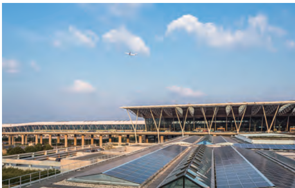
图 10-52 浦东机场的屋顶太阳能电池板
