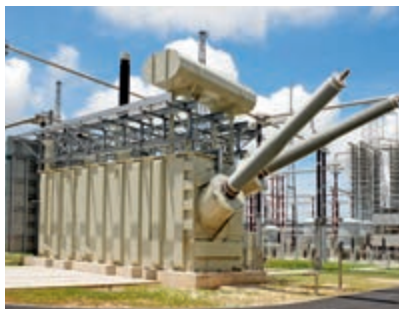
甲 变电站中的大型变压器
