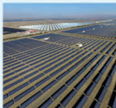
太阳能发电站
