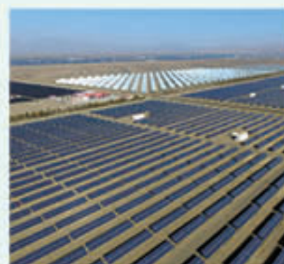
太阳能发电站
