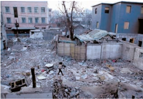
拆毁后的梁思成、林徽因故居
