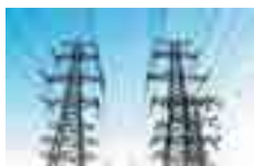
高压输电可达1 000 kV
