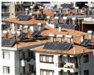
图 11-5-6 架设在屋顶的太阳能集热器
