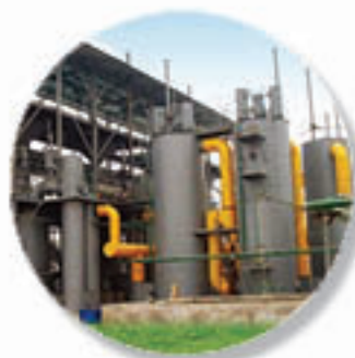
煤转化成煤气运出去
